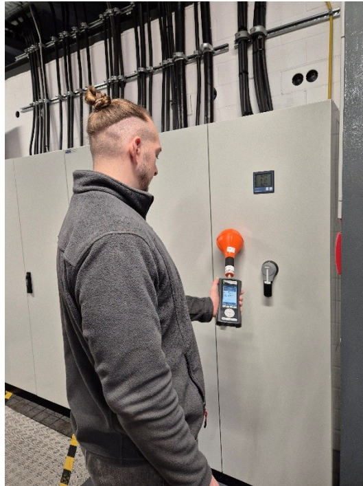
Messung mit Wavecontrol SMP 2
